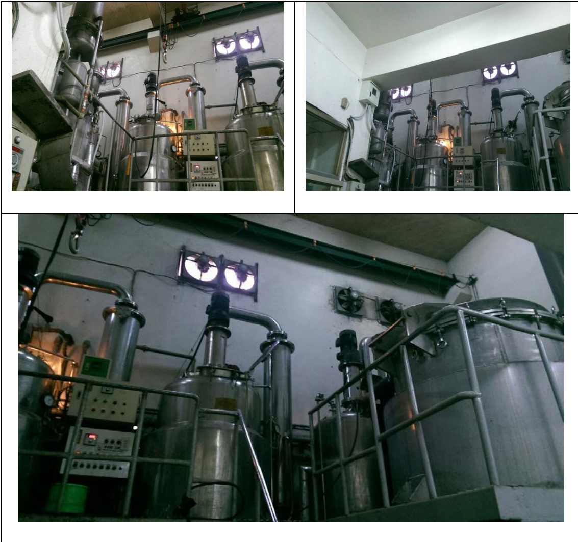
圖 40 H場所廠房熱水鍋爐作業區局部照片
