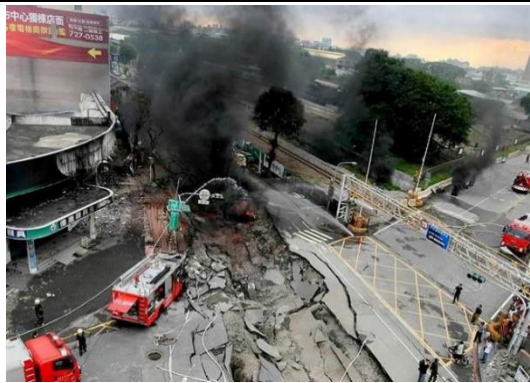
氣爆現場狀況 1
