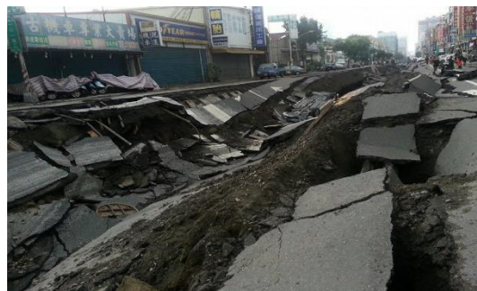
氣爆現場狀況 4
