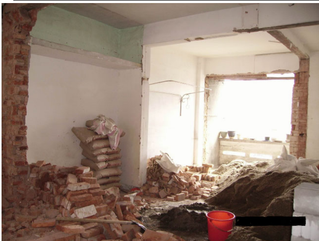
Hình 2.5 Tường bên ngoài bị đổ, có nghi ngờ có sự sụp đổ phải có lan can an toàn bảo vệ hoặc để biển thông báo như trong hình 2.4
