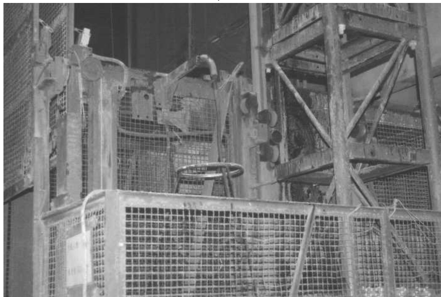
照片2 施工電梯之電纜箱(照片中中間之圓圈即是 ) (資料來源：本計劃參與人員自行拍攝)
