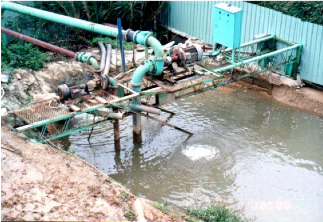
照片3 沉澱池(資料來源：台北市工礦安全衛生技師公會)
