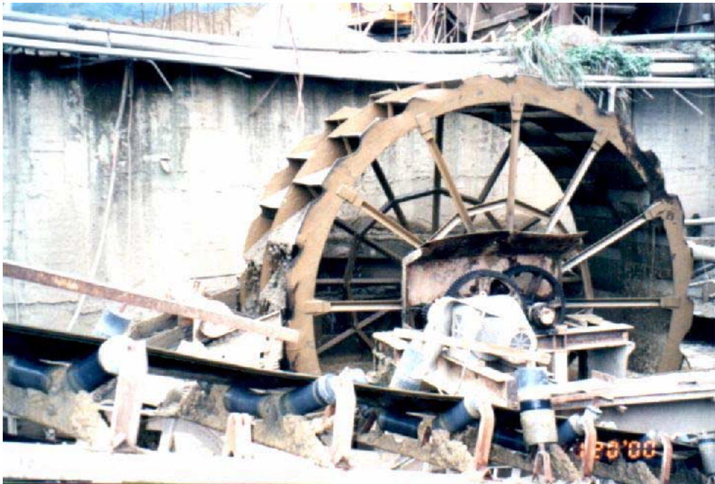
照片2 洗砂機(2)(資料來源：台北市工礦安全衛生技師公會)
