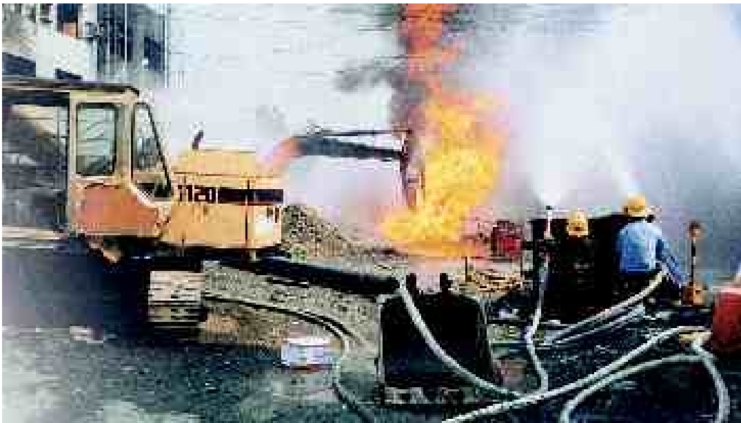
圖 1 鎮興橋液化石油氣管線拆遷工程爆炸及大火現況
