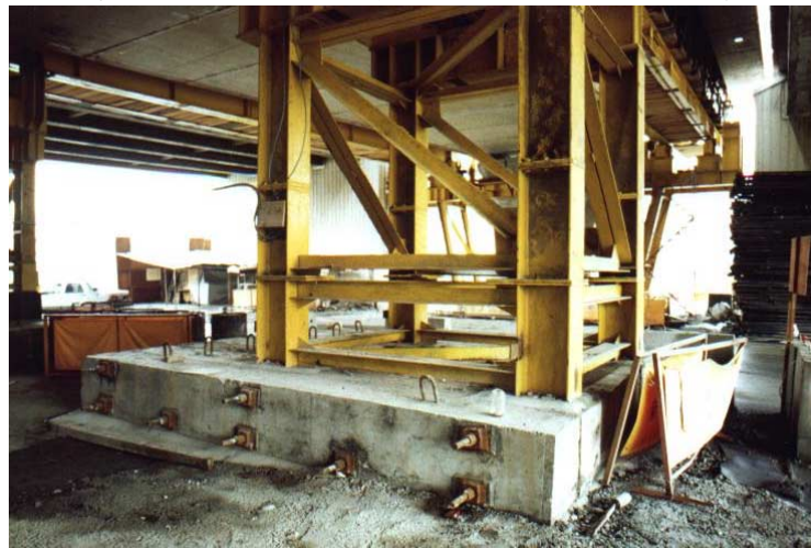
照片3 預鑄預力節塊吊裝工法之臨時支撐塔架設置 (資料來源：本計劃參與人員自行拍攝)
