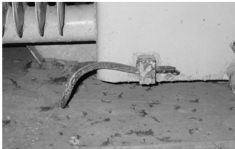
圖 10 用戶自備變壓器外殼接地之情形
