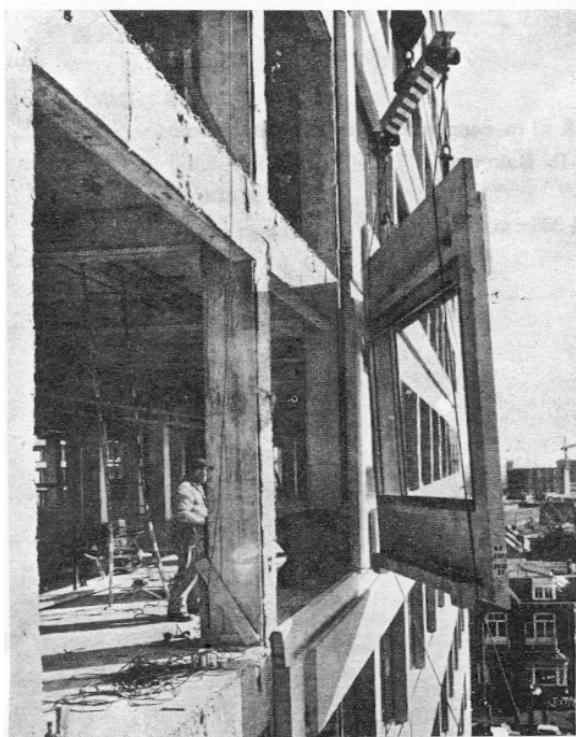
圖4 帷幕牆吊裝作業人員未做好安全措施例 (資料來源：葉基棟、吳卓夫-營造法與施工)
