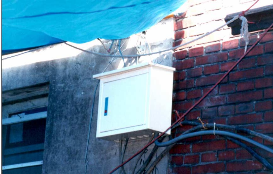
照片4 臨時配電盤之設置(資料來源：台北市工礦安全衛生技師公會)
