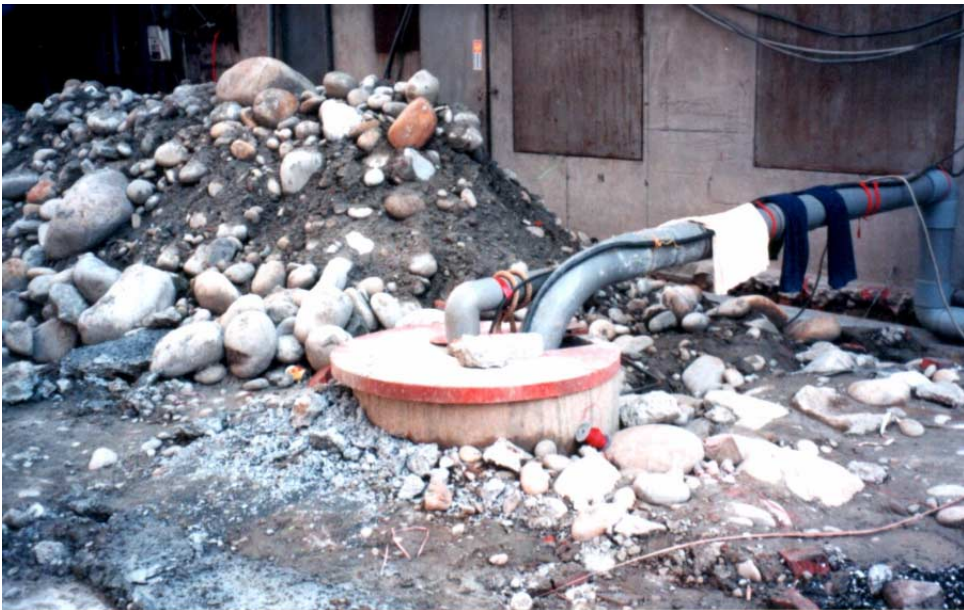
照片6 抽水設備(資料來源：台北市工礦安全衛生技師公會)
