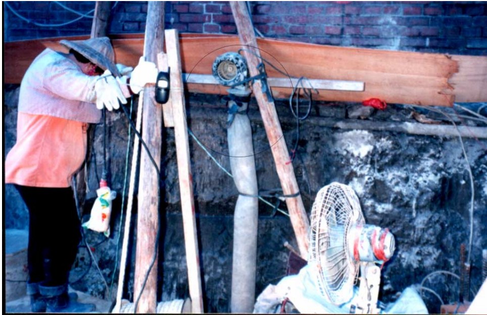
照片5 送風設備(資料來源：台北市工礦安全衛生技師公會)
