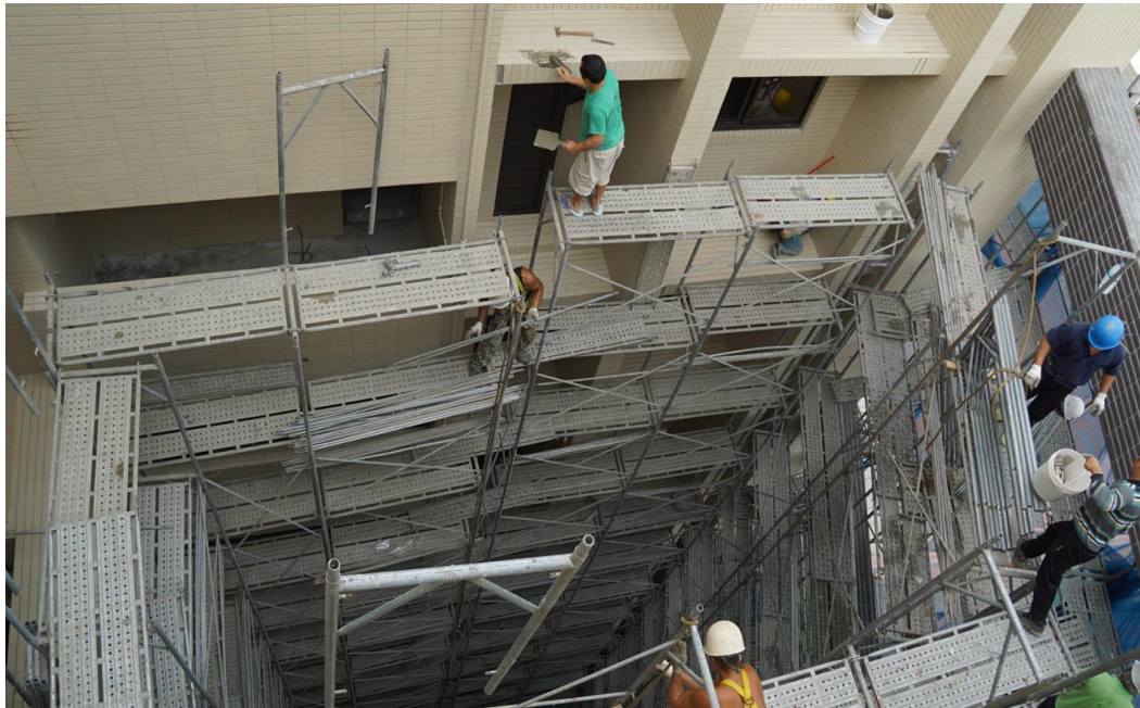
照片 2 泥作工站立於不安全位置施工且未繫掛安全帶
