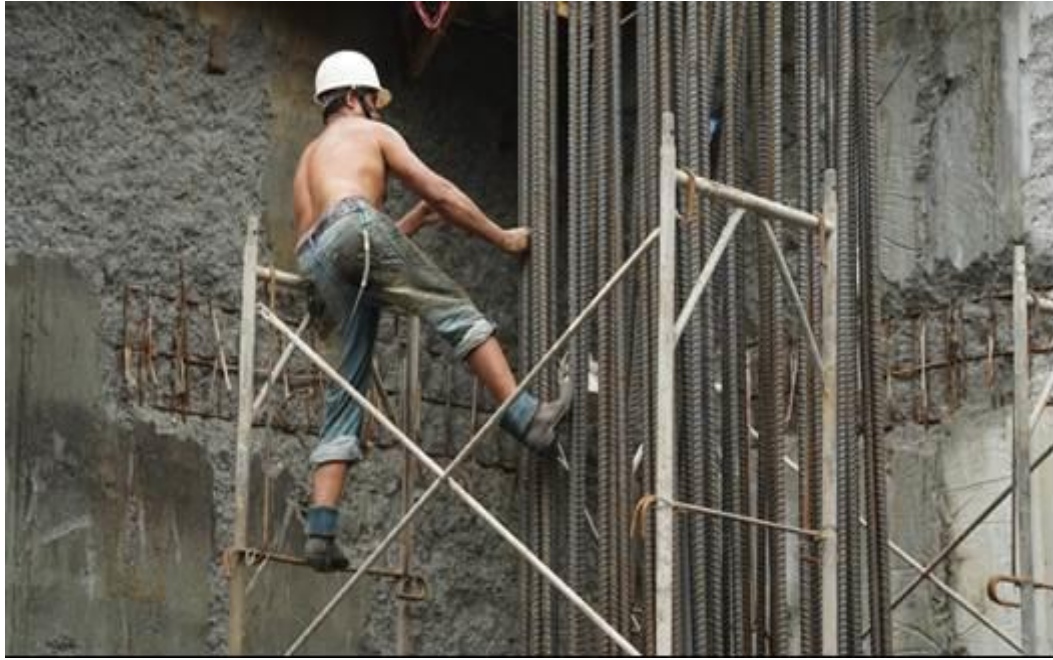
照片 1 鋼筋工站立於不安全位置調整鋼筋且未繫掛安全帶
