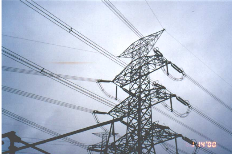
照片3 架線完成後之鐵塔(資料來源：台北市工礦安全衛生技師公會)
