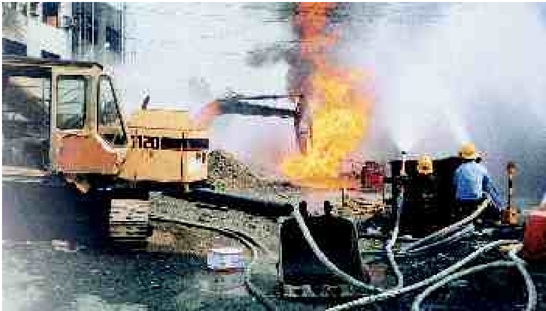
圖 2 鎮興橋液化石油氣管線拆遷工程爆炸及大火現況
