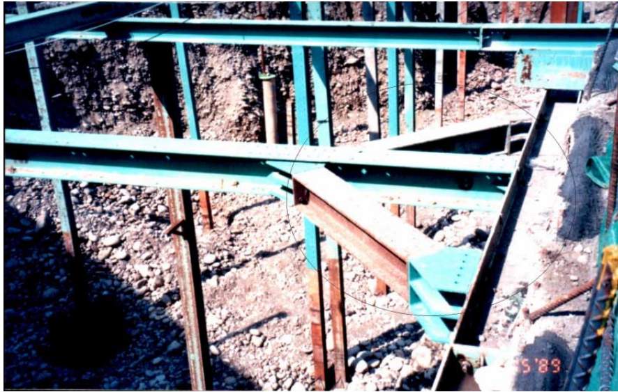
照片2 斜撐與橫擋(資料來源：台北市工礦安全衛生技師公會)
