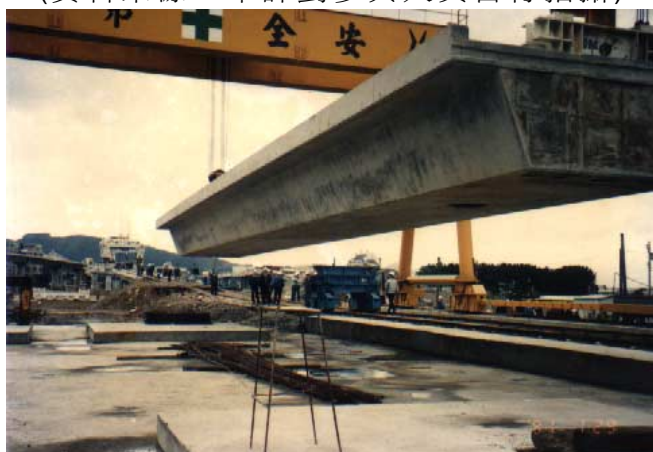
照片12 吊昇機具架梁作業施工情形 (資料來源：本計劃參與人員自行拍攝)
