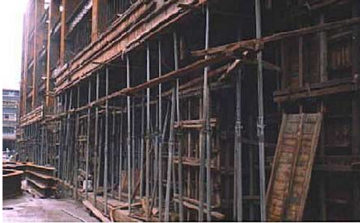
照片2 支撐應做適當之水平牽條或斜向支撐(資料來源：根基營造(股)公司)
