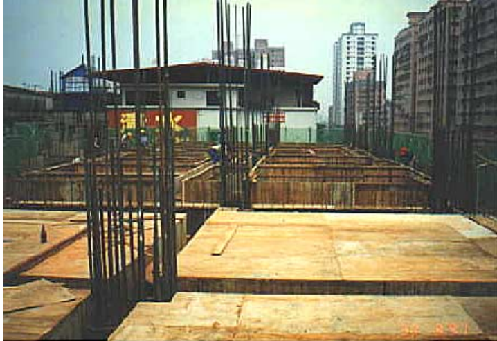
照片5各階段作業場所應保持整齊(資料來源：根基營造(股)公司)
